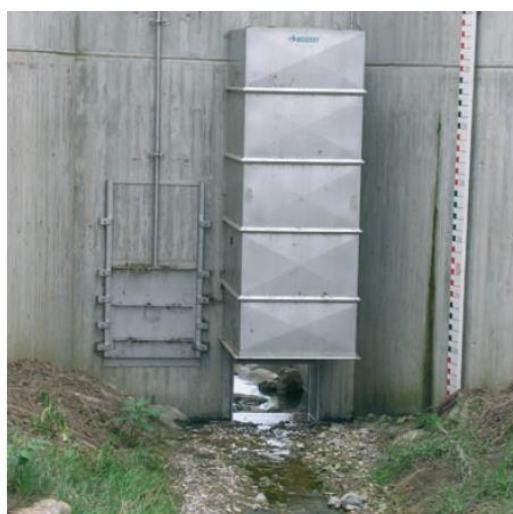
Bild 3.9 Schwimmergesteuerter Schieber (unter der Abdeckung); HRB Apfelbach/Affalterbach
